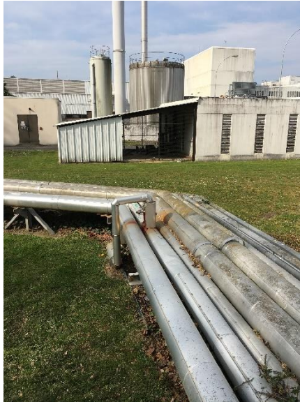
Figure 5-4 : Rack tuyauterie (eau, vapeur et électricité)
