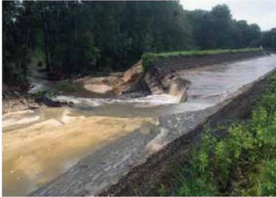
Figure 6-1 : Retour d'expérience d'une rupture de l'endiguement d'un canal – Source : www.aria.developpement-durable.gouv.fr
